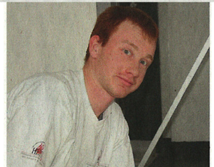
Damit dem Badegenuss der Gäste nichts im Weg steht, verlegt Marco Kiser aus Alpnach die Plättli.
